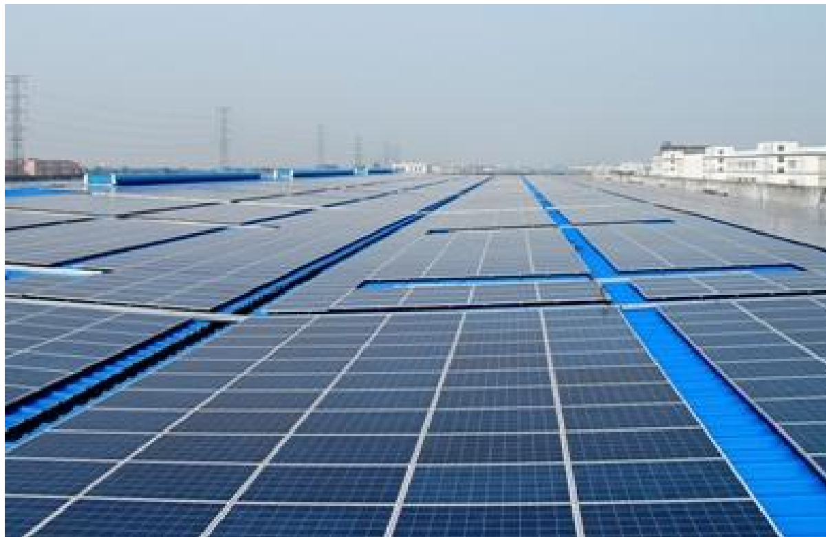
振东科技园 光伏发电站项目
